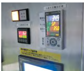
制御盤パネル面
