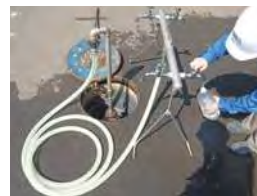
応急給水(ラクエア+給水栓)
